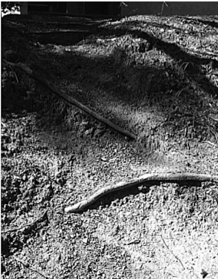
Figura 6: Erosão, devido a escoamento superficial e falta de vegetação. Fonte: Siqueira 2015
