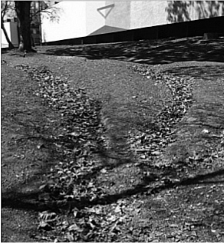
Figura 5: Erosão, devido a escoamento superficial. Fonte: Siqueira. 2015
