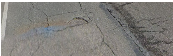
Figure 7: Hendidura detectada por el sistema y provocada por una tapa de alcantarilla..
