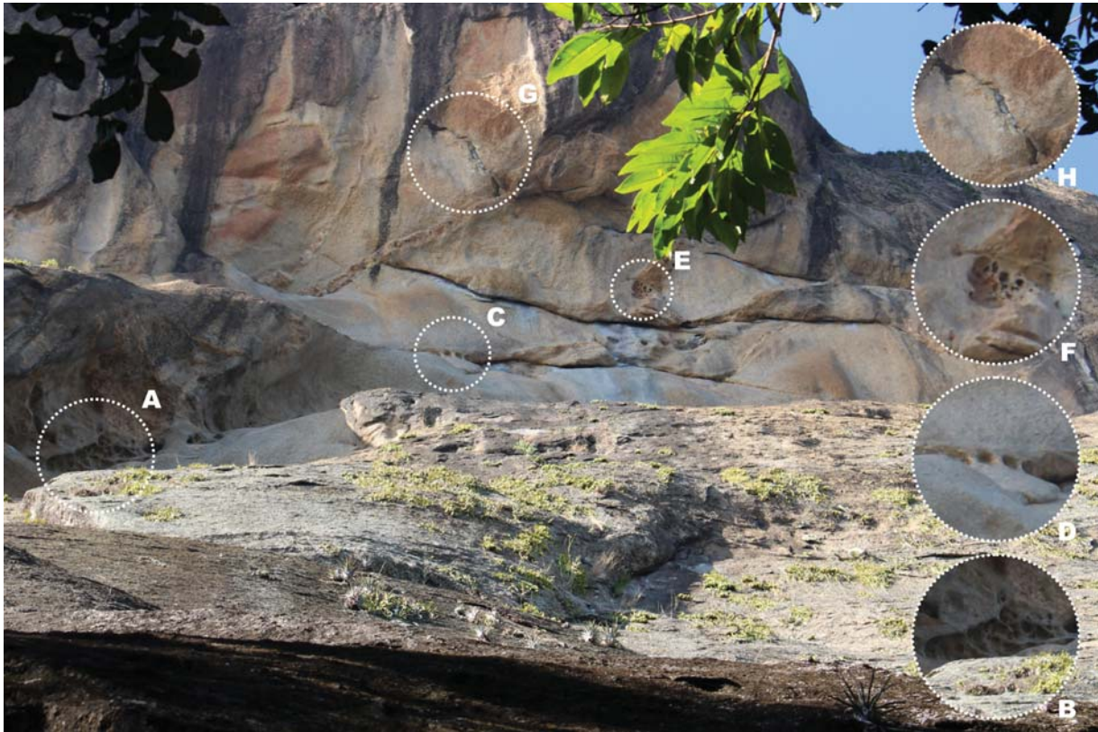
Fig. 7. La presencia de los tafoni, estructuras asociadas y sistema de discontinuidades en la vertiente norte del Pão de Açúcar. A-B) Registro de estructuras menores de panales ( honeycombs ); C-D) Presencia de alvéolos o arcadas lenticulares entre los planos de fractura (planos subverticales y verticales); E-F) Estructura en panal ( honeycombs ) sobre una concavidad en la parte inferior de la fractura de descamación suspensa; G-H) Disposición de venas de pegmatitas. Los escurrimientos de agua desde la parte mas alta del domo permiten la colonización, probablemente por líquenes, en la pared rocosa protegida de la lluvia. A la derecha de C y por debajo de E pueden verse en color gris claro los depósitos de ópalo biogénico formados en el interior de las fisuras entre la sheet structure (Caldcleugh 1829). (Fotografía: Felipe Waldherr).
