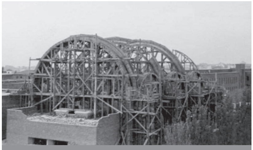
03 Construcción de la iglesia del Espíritu Santo sobre los restos del salón de actos del Instituto-Escuela en la Colina de los Chopos, Madrid. El arquitecto en los andamios, h. 1945.
